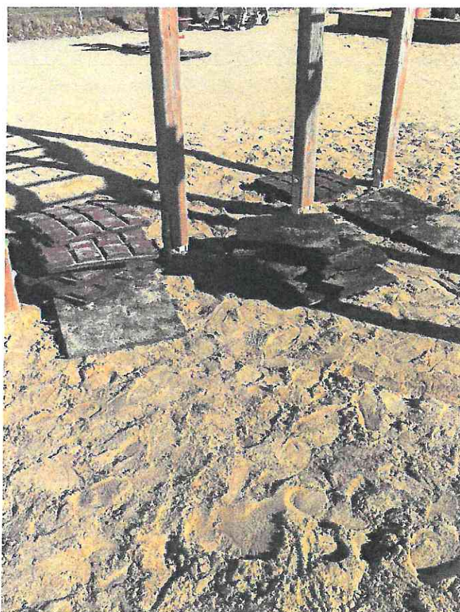
Fot. 6. Braki płyt gumowych przy elementach wyposażenia placu zabaw
