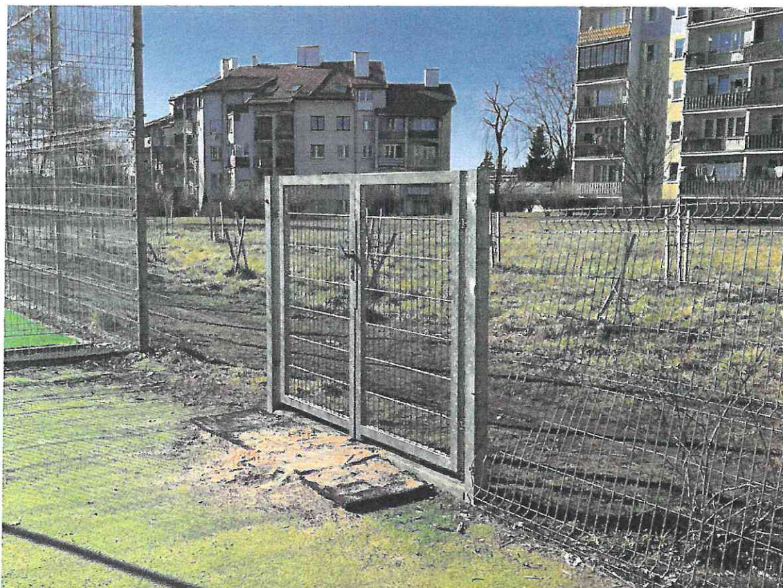
Fot. 5. Uszkodzenia ogrodzenia przy placu zabaw
